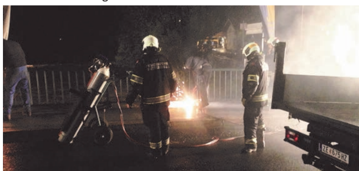
Um 2:30 Uhr in der Nacht wurde die Entfernung der Geländer an der Salzachbrücke vorgenommen, da diese beim Überströmen der Salzach durch mitgeführtes Schwemholz verklausen können. (Bild: FF Mittersill)
