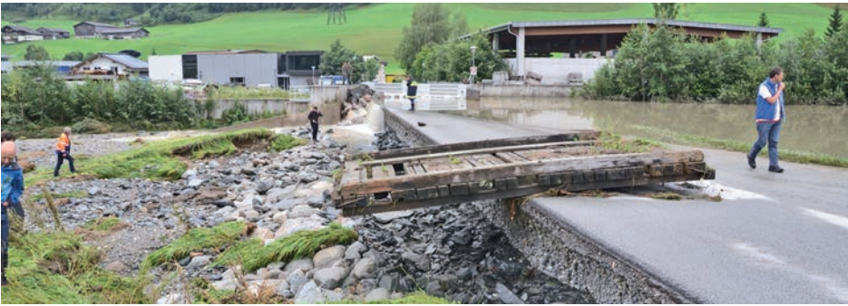
Die Rettenbachstraße ist zugleich der Damm für das Retentionsbecken westlich der Straße. Beim vergangenen Hochwasser wurde die Straße stark unterspült. (Bild: Feuerwehr Mittersill)
